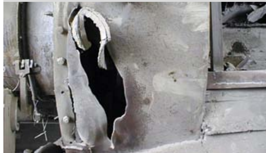
Улитка промышленного вентилятора, порванная оторванной лопаткой рабочего колеса
