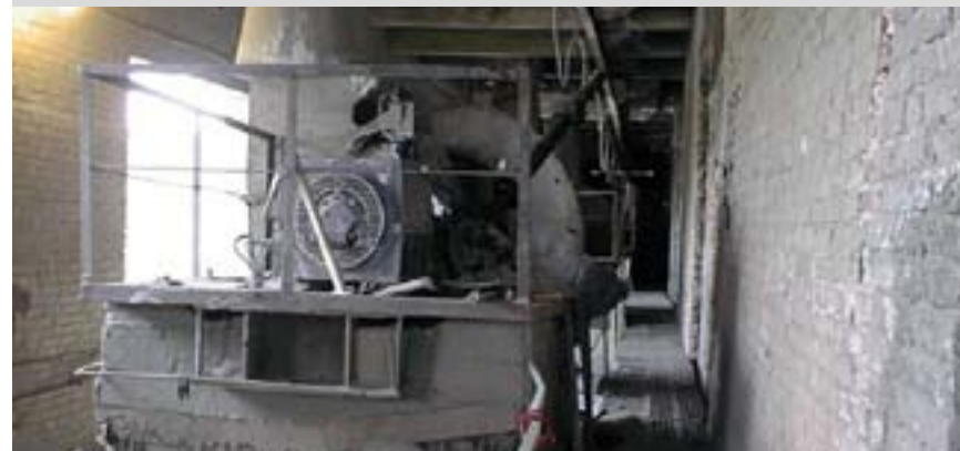
Общий вид разрушенного вентилятора.
